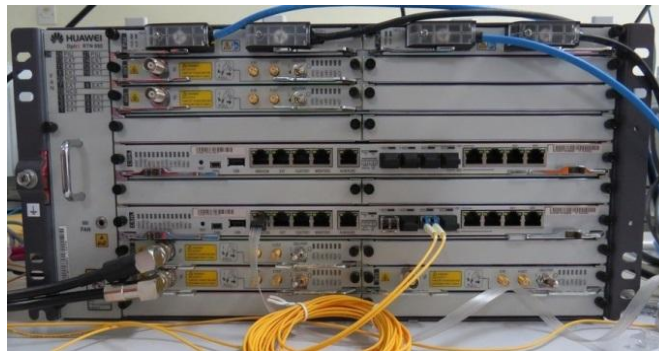
Gambar 1. Perangkat Indoor Unit Radio Microwave Huawei RTN 980L
